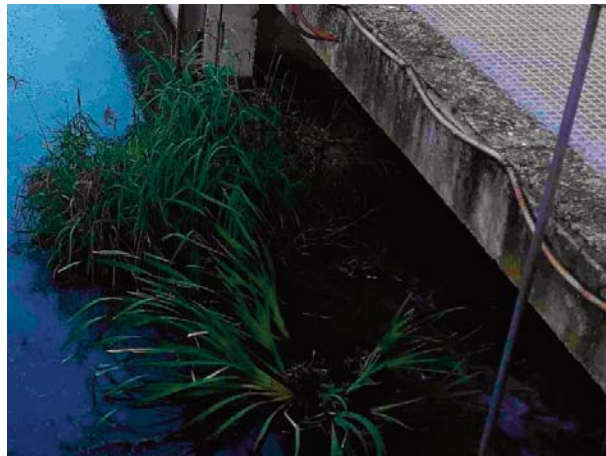
Όλα τα λύματα χωρίς καμία επεξεργασία καταλήγουν στον υδροφόρο ορίζοντα
